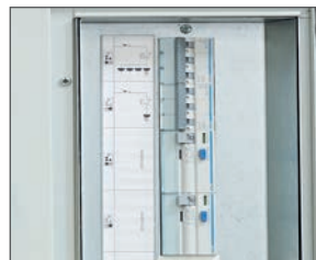
Lähtöjen nimikoinnit ovat keskuksissa valmiina.
