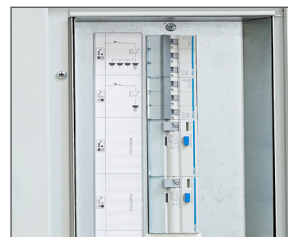
Lähtöjen nimikoinnit ovat keskuksissa valmiina.
