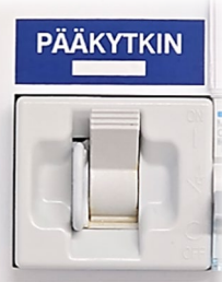
Pääkytkin I-asennossa (sähköt päällä)
