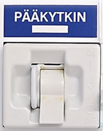
Pääkytkin O-asennossa (sähköt pois)
